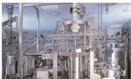
Anlage zur chromatographischen Aufreinigung. Produktion des Biotest Medikaments Intratect Chromatographic purification equipment. Production of the Intratect medication by Biotest.
