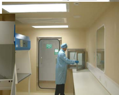
Materialschleuse mit Notausgang im Hintergrund
